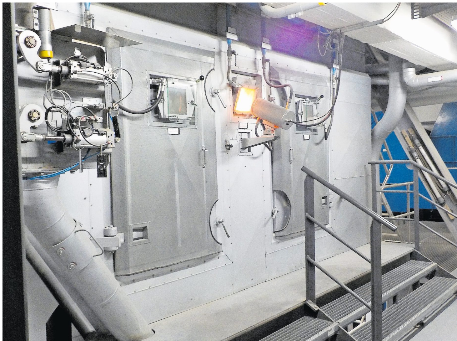
In einem solchen Kessel wird Fernwärme hergestellt. Auch die Stadt Wil möchte künftig auf diese Form von Energie setzen.
